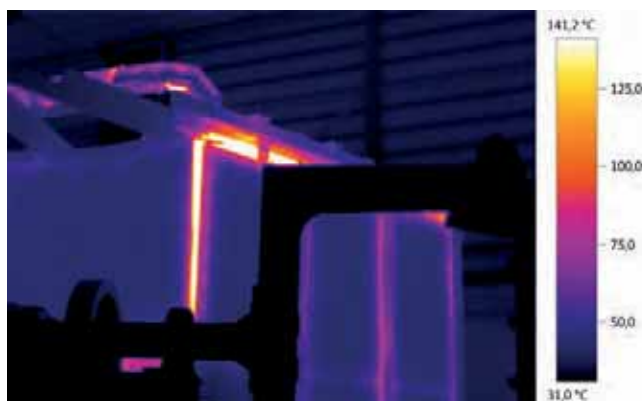
Horno industrial con fallo de aislamiento.
